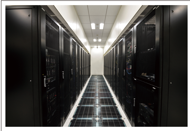
図1 データセンター内部イメージ
