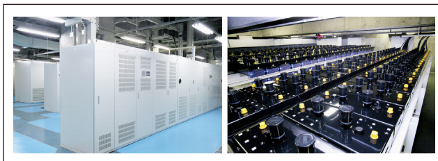
図7 UPSとバッテリー
